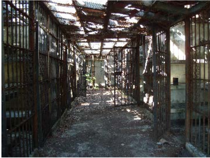
Foto. 5. Vista del espacio interior de la cárcel. Nótese el mal estado de la edificación (fuente: investigación directa, enero de 2009).
